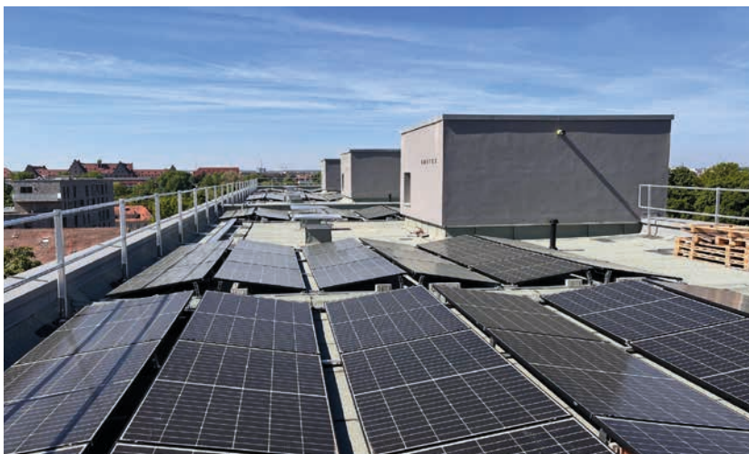
Photovoltaikanlage St. Johannis.
